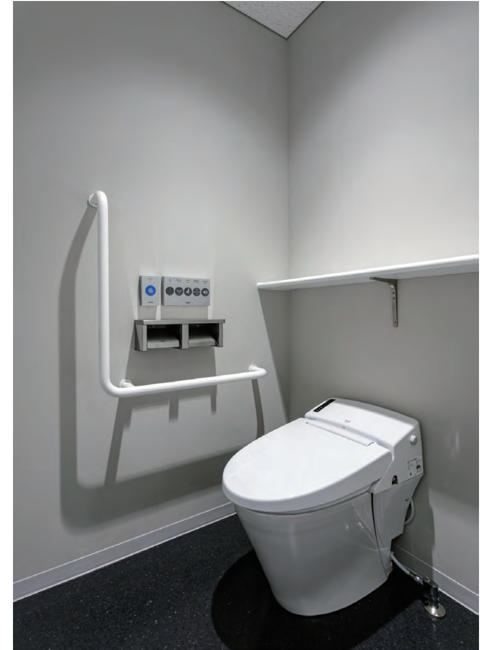
男性用トイレ 大便器
