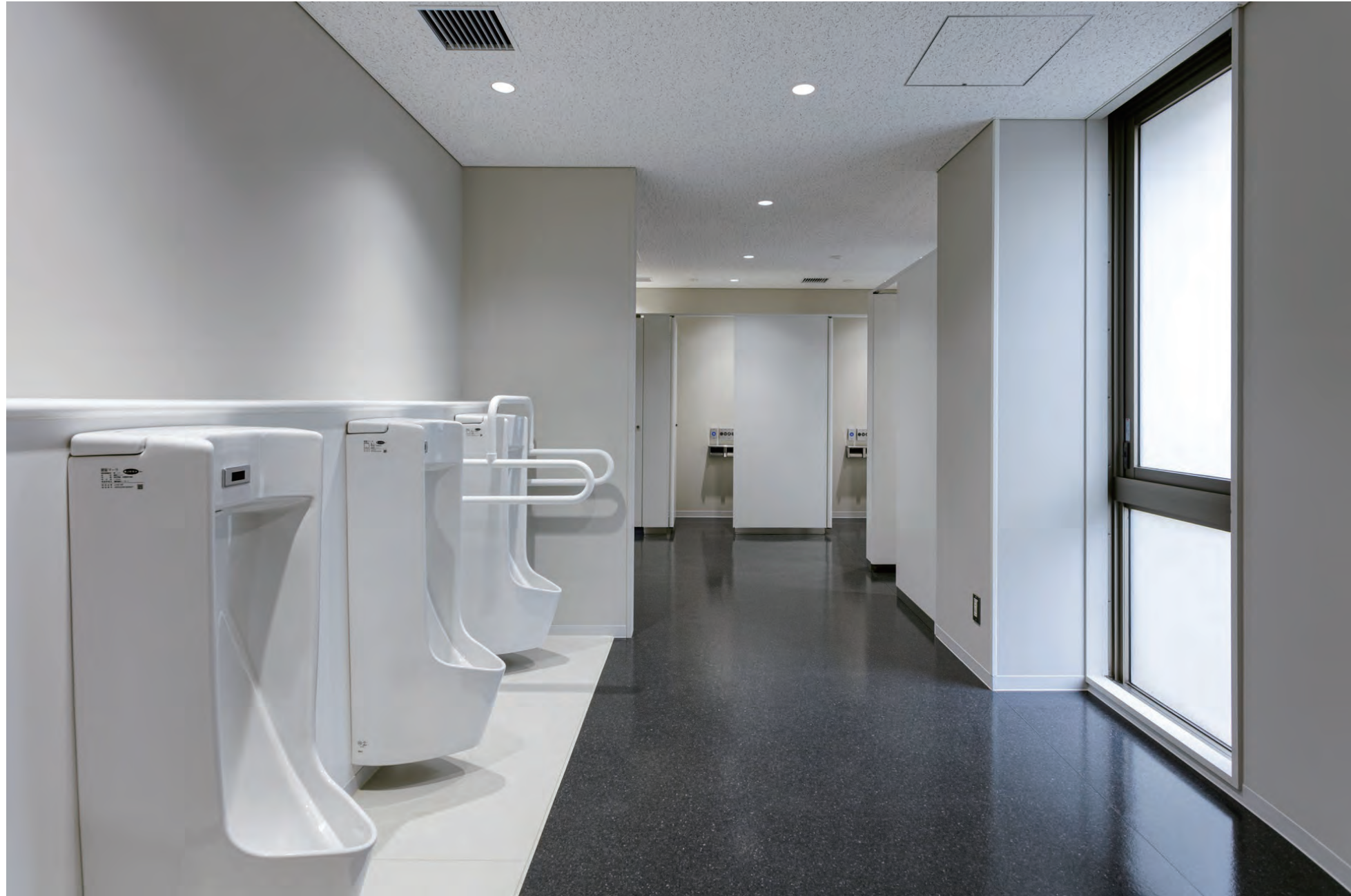
男性用トイレ 小便器
