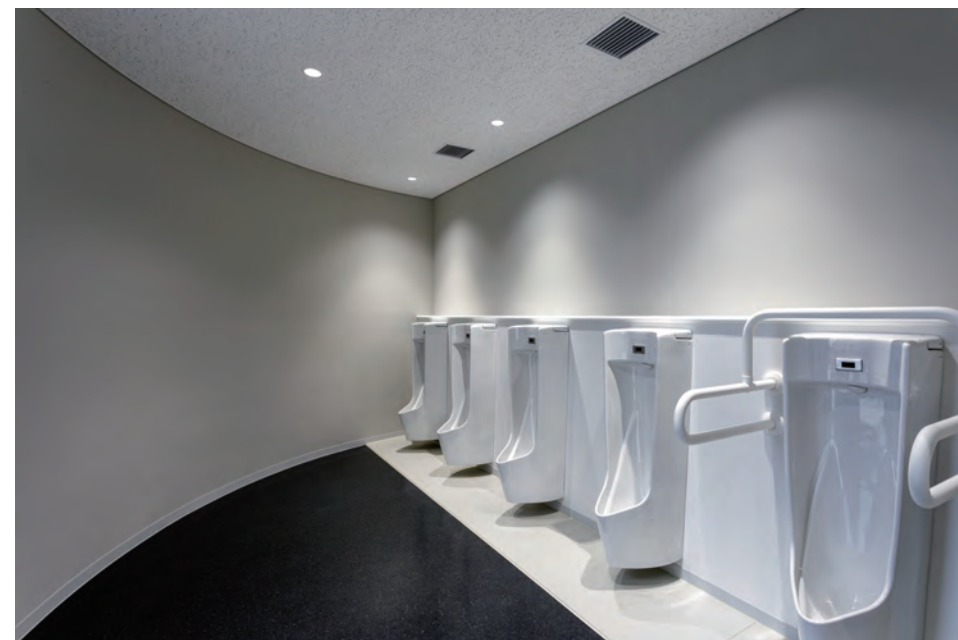
男性用トイレ 小便器
