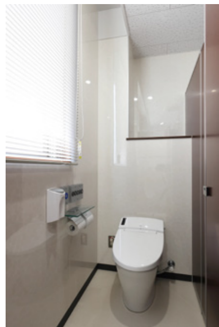
2F男性用トイレ 大便器
