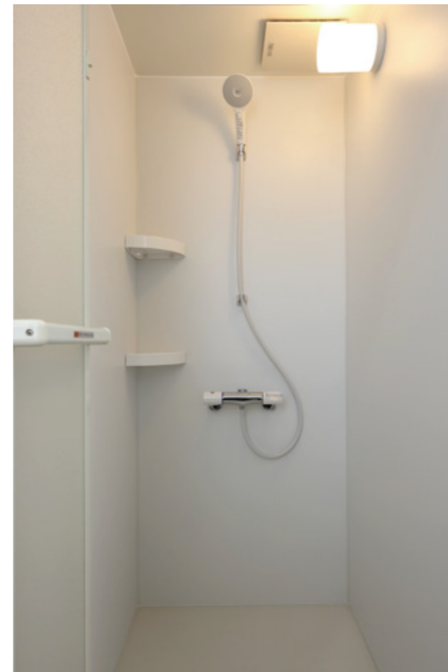
2F 浴室・脱衣室 シャワーユニット
