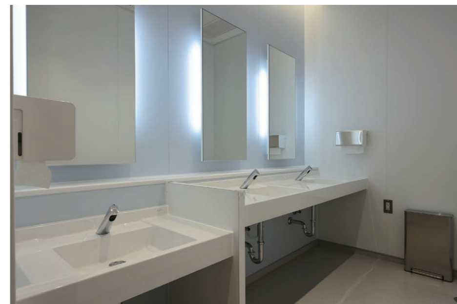
1F 男性用トイレ 洗面カウンター
