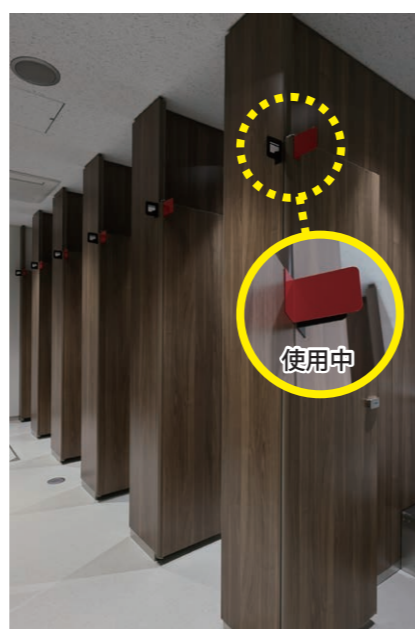
1F 女性用トイレ 空室サイン
