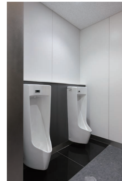
男性用トイレ(エントランス) 小便器
