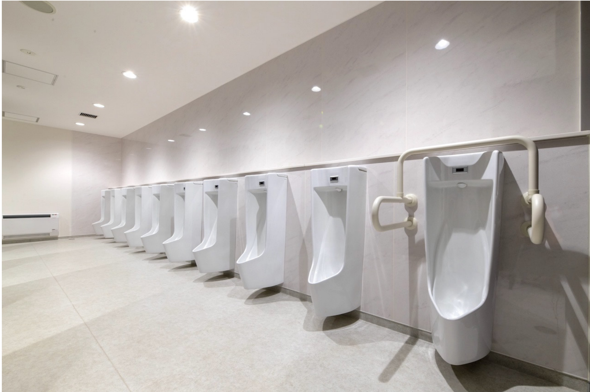
男性用トイレ 小便器
