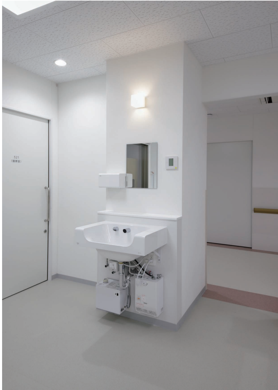
3F スタッフステーション 手洗器
