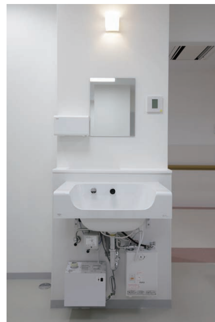
3F スタッフステーション 手洗器
