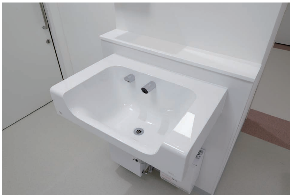
3F スタッフステーション 手洗器
