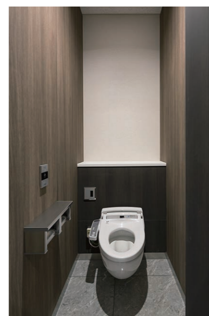
B1F 男性用トイレ 大便器
