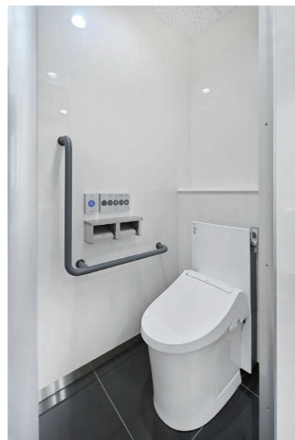
女性用トイレ 大便器
