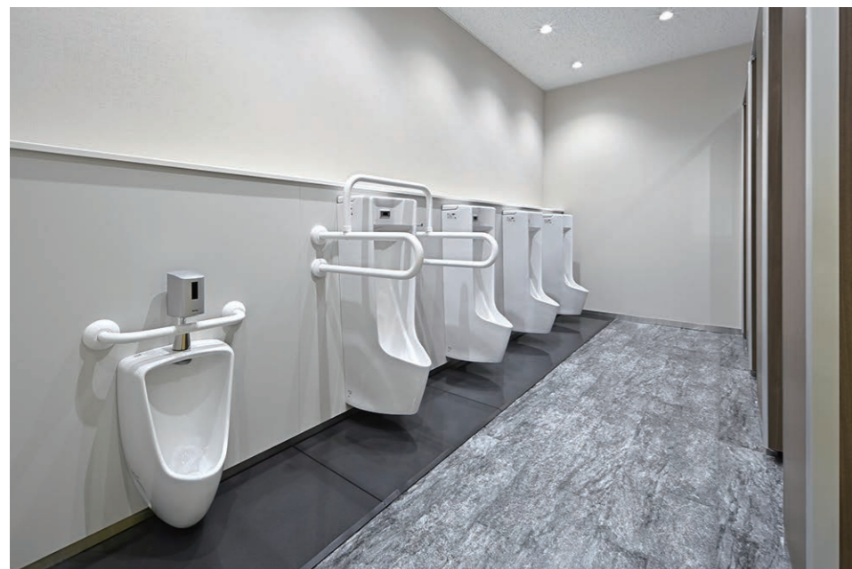
男性用トイレ 小便器
