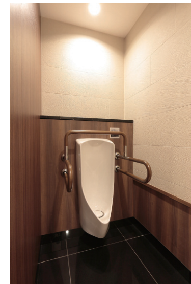
無水小便器 / 手すり
