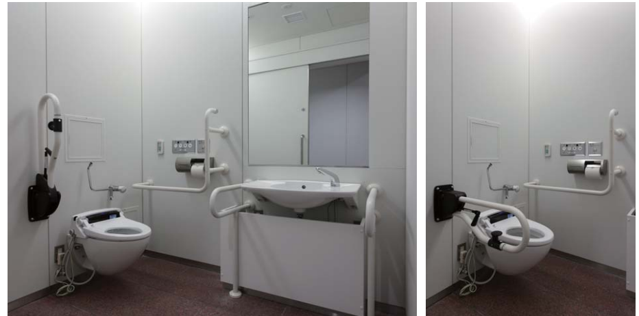
多くの方の利用に合わせ多目的トイレを男女問わず使えるよう入り口付近に設置
