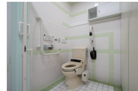
大便器ブース / 便座昇降装置を設置
