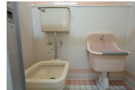
汚物流し・掃除用流しまわり
