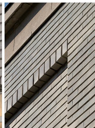
部分的に張り替えたタイル
