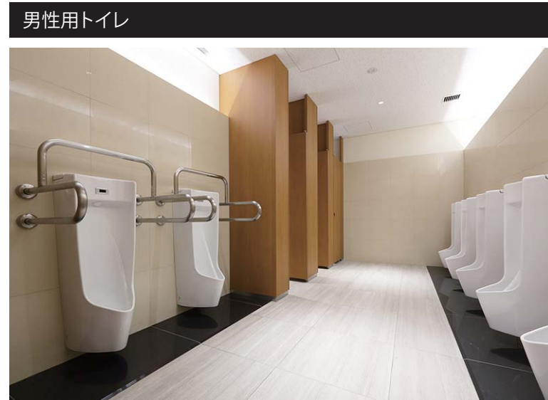
男性用トイレ 上質感を演出したトイレ空間。小便器は壁掛式&シンプル形状で清掃性に優れ、小便器下には汚垂石を設置し尿だれに配慮。様々な利用者を想定し、各所に手すりを設置している他、ベビーシートやベビーキープを備えた個室を設け、子供連れの男性も安心して利用することができる。
