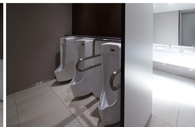
小便器は床の清掃がしやすい壁掛けタイプを採用。尿だれも考慮し、小便器下には汚垂石を設置している。
