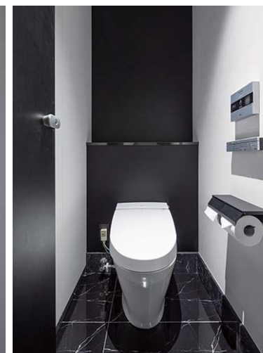
女性用トイレ 大便器
