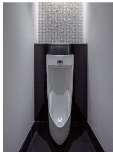
男性用トイレ 小便器
