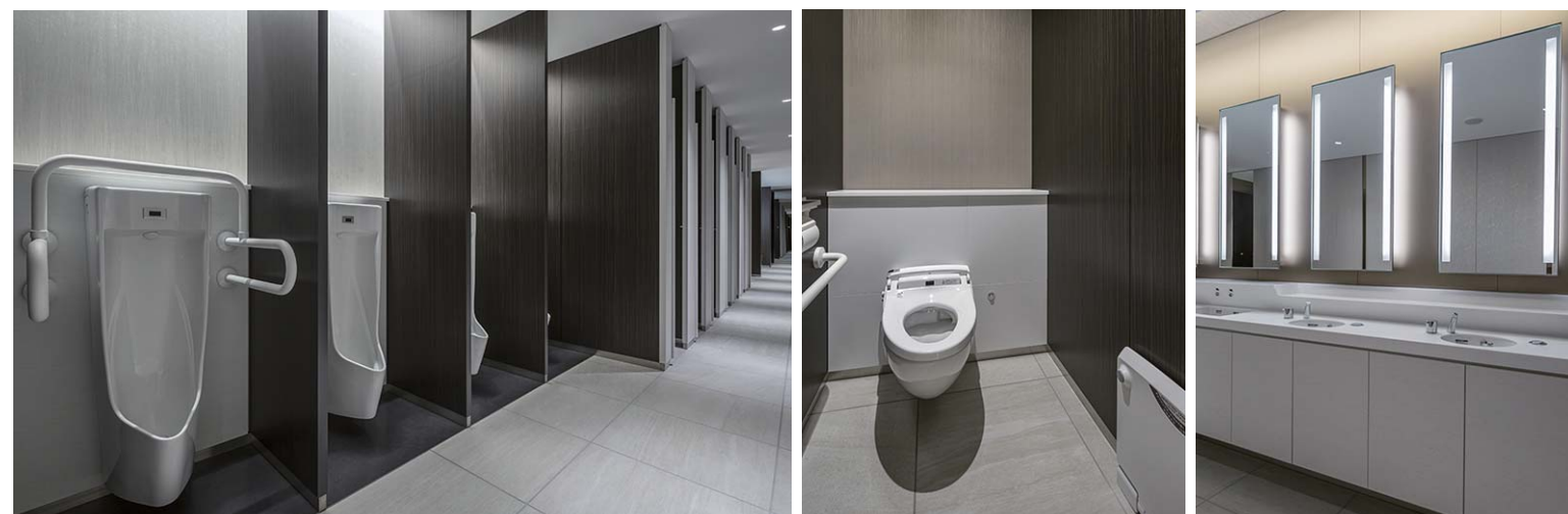
小便器間に設けたパーティションや、着替えに便利なチェンジングボードなど、利用者の快適性を高めたトイレ室内。洗面エリアには、ランチ後の歯磨きの他、感染症予防に欠かせないうがいにも便利な歯磨きコーナーを設置。コップなしで口をすすげる上向き吐水の水栓やボウルの洗浄ボタンを備えている。
