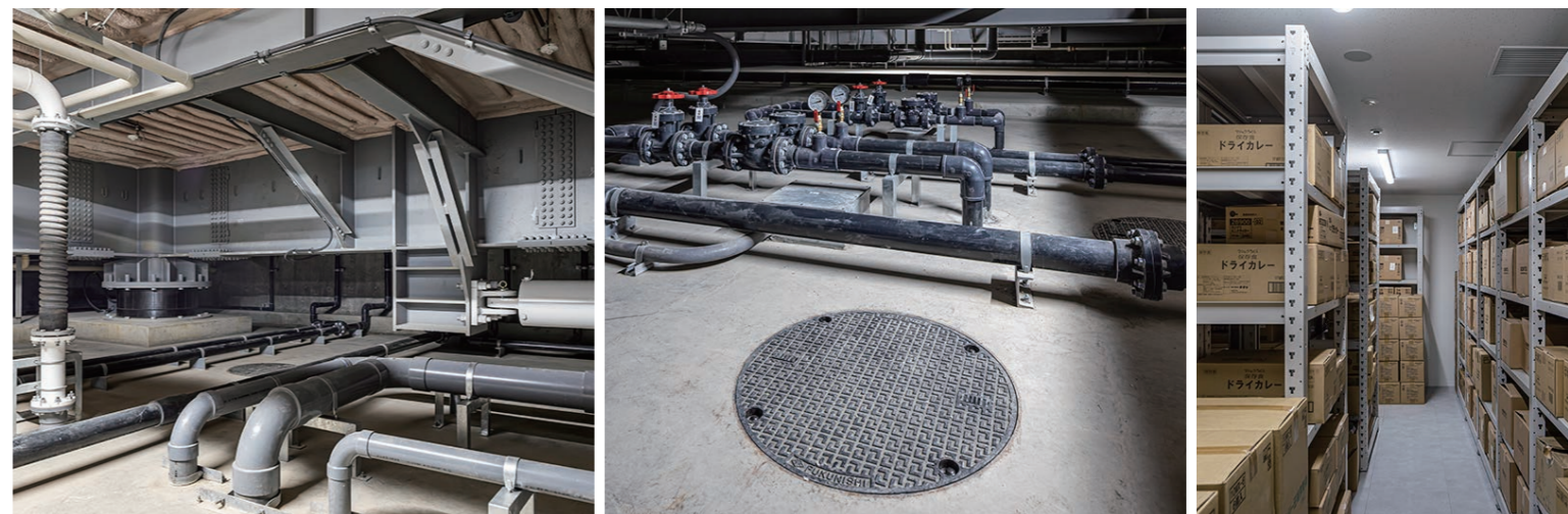
免震装置とダンパーが地震による揺れを軽減。階上の污水配管から污水ピットへの接続部には排水可とう管を設置し、排水管の破損リスクを軽減。污水ピットは污水を3日間貯留でき、大型貯水槽、自家発電機、水・食糧・携帯トイレなどの備蓄品を備えた防災倉庫も設置し、非常時でも可能な限り通常稼働できるインフラ機能を確保している。
