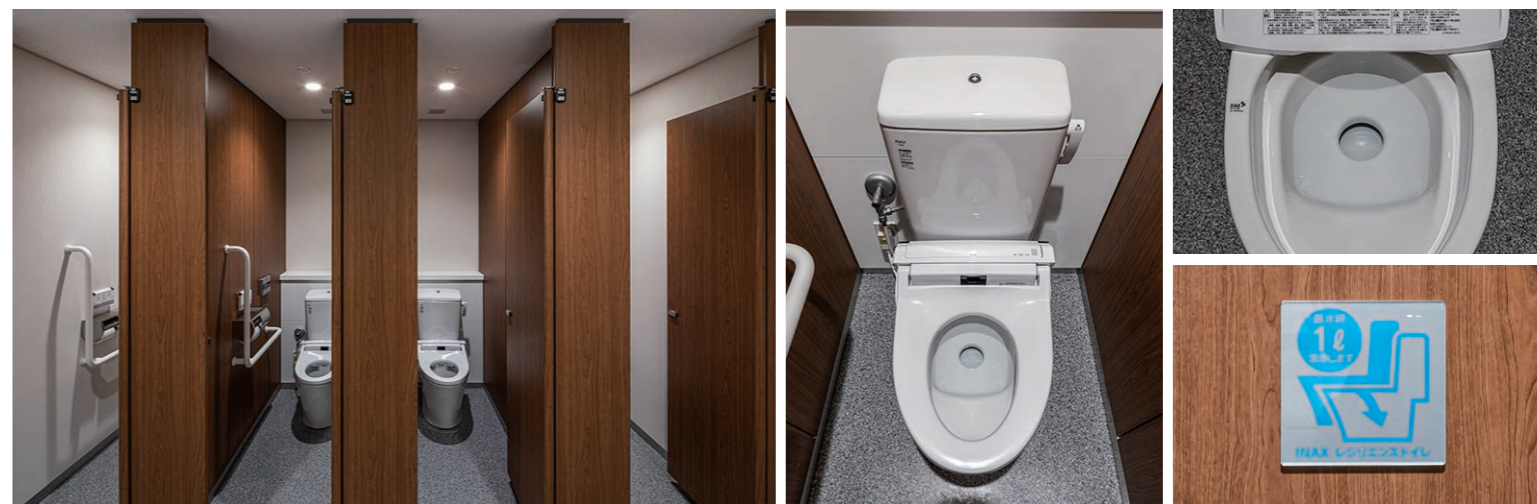
平常時は洗浄水量5Lの水洗トイレとして使用し、災害時も同じ場所で洗浄水量を1Lに切替えて使用できる。大便器ブース内には従業員が協力して災害時の対応ができるようレジリエンストイレを周知するプレートを設置している。
