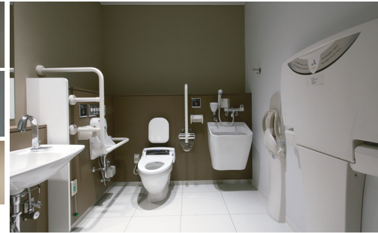
身障者や子連れでの利用も想定して、オストメイト用汚物流しやベビーキープ・ベビーシートを設置している
