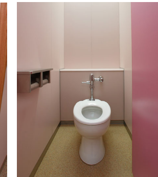
大便器ブース / 洋風便器
