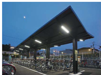
柱の数に合わせて12カ所つけたLED照明。後づけの照明にはない美しい仕上がり特徴
