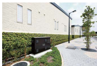
パワーコンディショナーのキャビネット。太陽電池モジュールによる直流の電気を交流に変換する。駅の壁面緑化の高さに合わせて設計。色はシェルター、防護柵と同じマイルドブラックで統一
