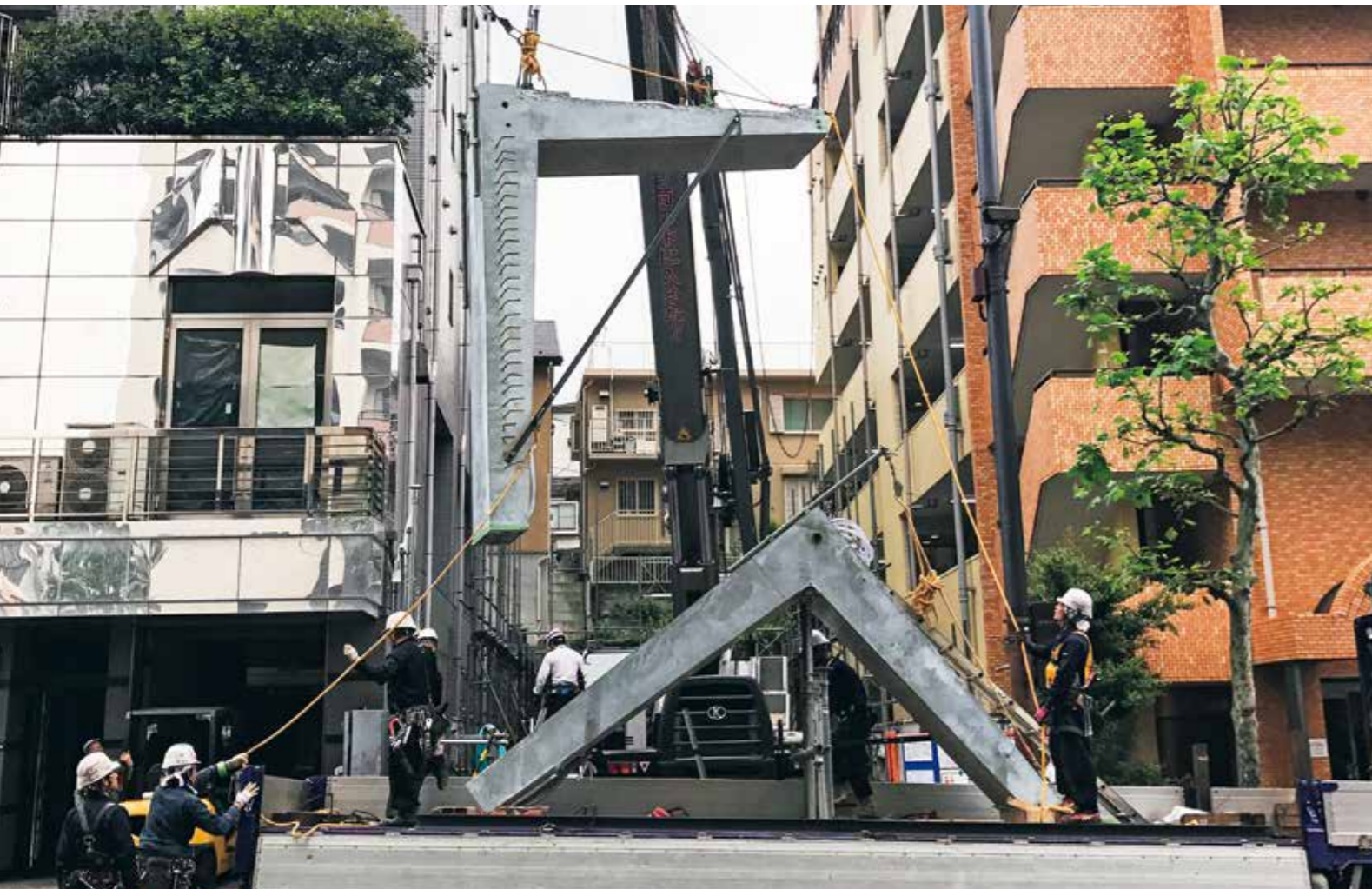
神楽坂S-oneの建て方。L字形のプレキャストコンクリート(PCa)ピースをクレーンで吊り上げ、所定の場所に設置するPCa+PCならではの施工風景 [写真: AIG]
